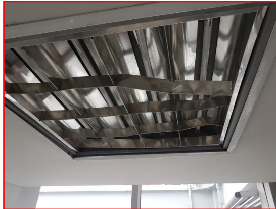
Lámparas en mal estado
